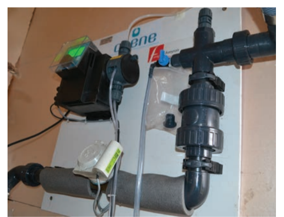
Un compteur d'eau a été installé sur la pompe pour connaître précisément la consommation.
