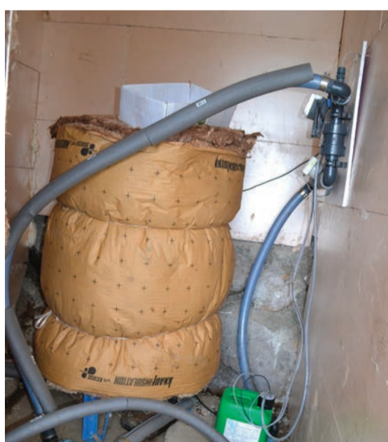
Christophe Rouchès a construit un petit local pour abriter la pompe et le traitement au chlore ainsi que la réserve d'eau.
